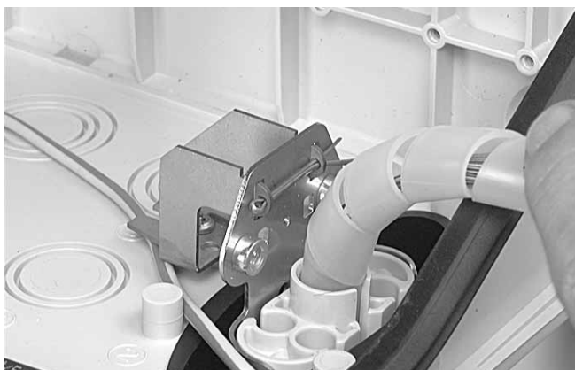
4.2.17 Введите транзитные волокна в герметизирующую овальную трубку, а затем в овальный порт бокса. Установите металлическую плату с закреплёнными кабелями на кронштейн и зафиксируйте с помощью шпильки.
