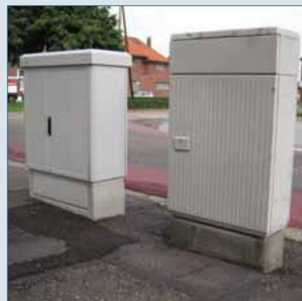
Шкаф XDSL Отдельно стоящий рядом с существующим медным распределительным шкафом
